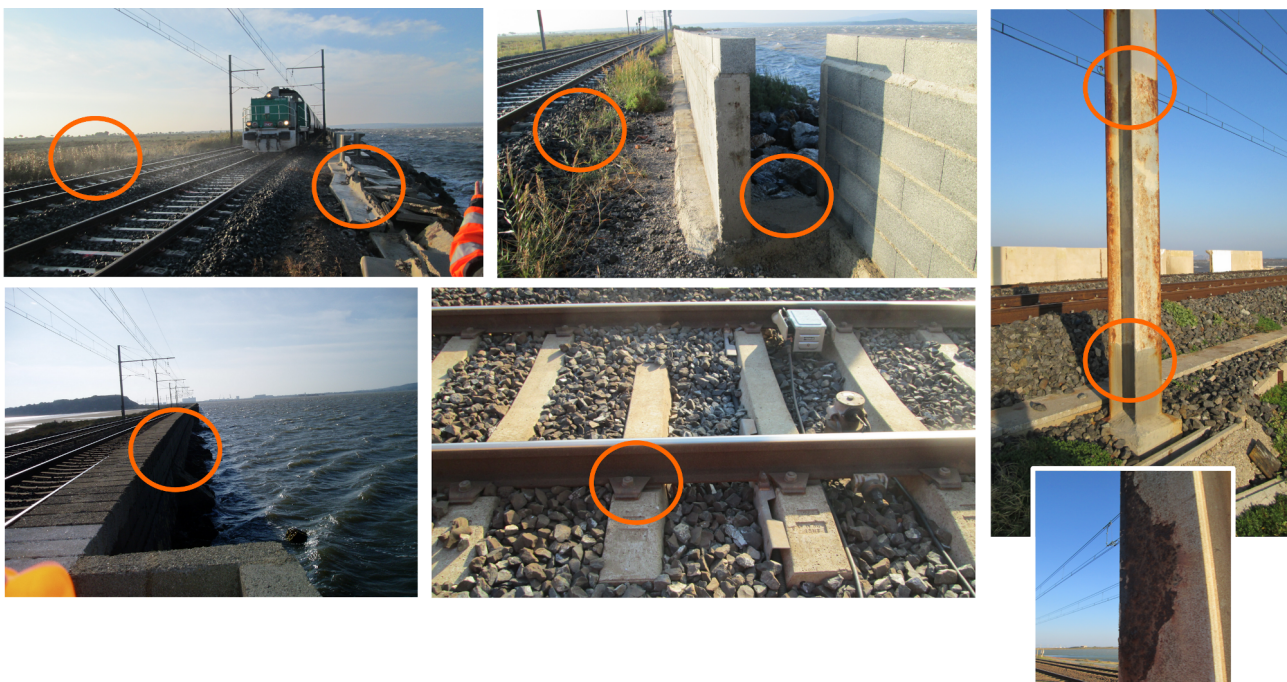
FIGURE 1.1 : Haut – Gauche : endommagement d'ouvrages traditionnels de protection ; centre : discontinuité dans l'ouvrage censé contrôler le franchissement ; droite : corrosion accrue des caténaires. Cette corrosion est différentielle (plus haut sur le caténaire opposé à l'étang). Bas – Gauche : dimensionnement d'ouvrage aberrant pour lutter contre le franchissement ; centre : corrosion sur écrou et rails.
