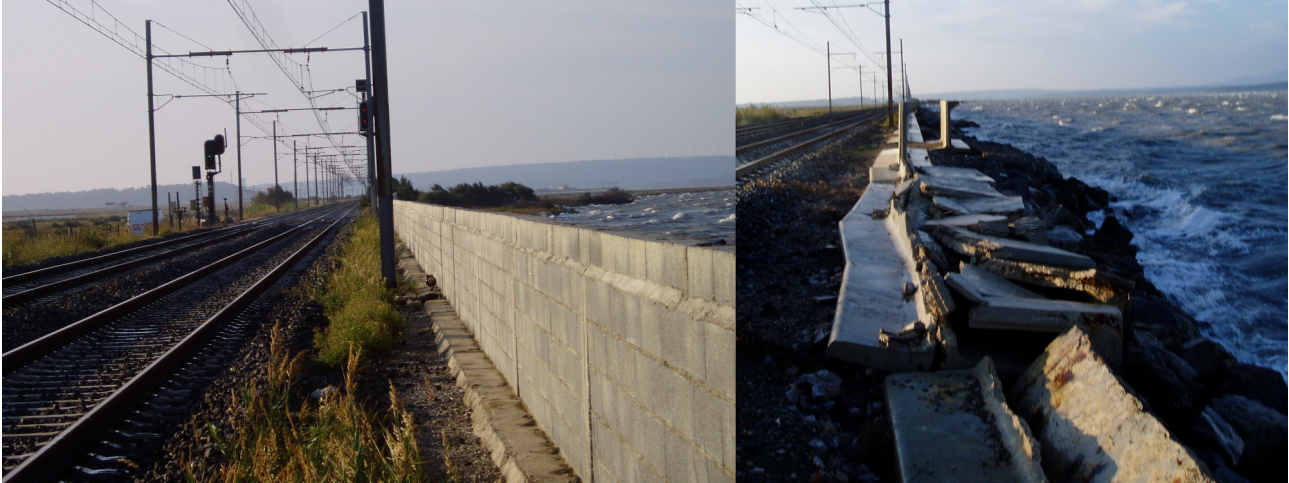
FIGURE 1.2 : Exemple de protection non adaptée (mur vertical face aux vagues) et endommagement consécutif à la non prise en compte de la surcôte en condition de tempête, des contraintes horizontales exercées par les vagues, et l'effet de sape des vagues en pied d'ouvrage par haut niveau.
